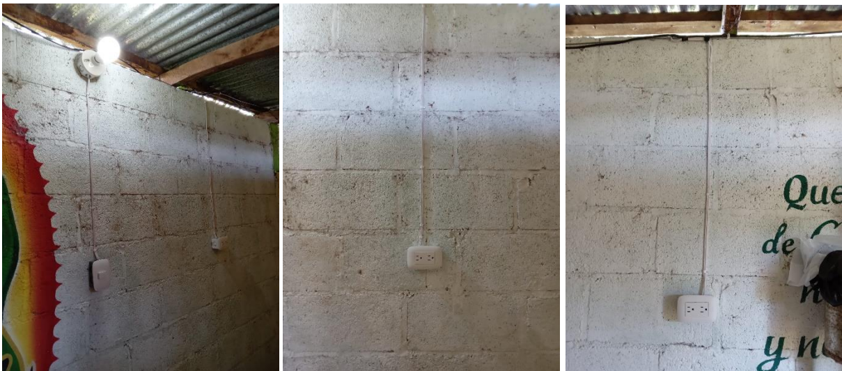
Instalación de energía eléctrica del estadio los Conacastes
