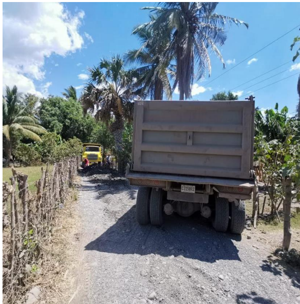
CONSERVACION Y MANTENIMIENTO DE CAMINOS DEL SECTOR RURAL, ALDEA SAN CRISTOBAL, CHIQUIMULILLA, SANTA ROSA.
