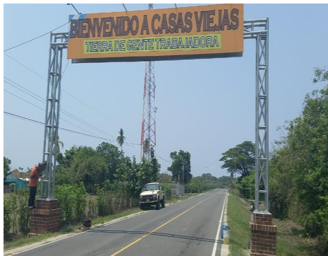
INSTALACIONES ROTULO DE SEÑALIZACIÓN E IDENTIFICACION DEL SECTOR ALDEA CASAS VIEJAS, CHIQUMULILLA, SANTA ROSA.
