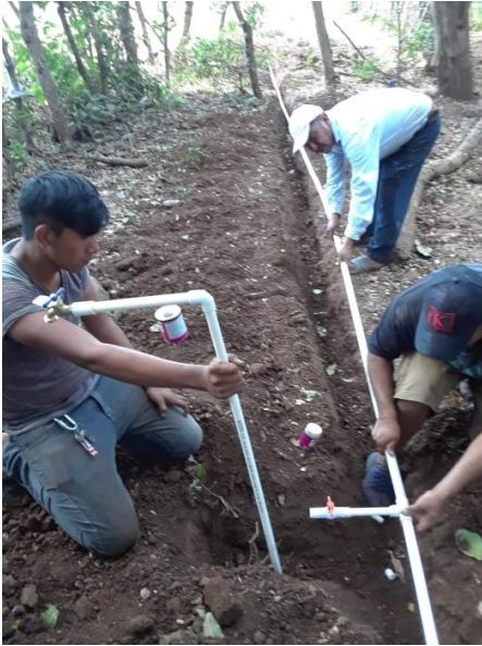
MEJORAMIENTO SISTEMA DE AGUA POTABLE ALDEA LOS CERRITOS, CHIQUIMULILLA, SANTA ROSA. (instalación tubería y bomba)
