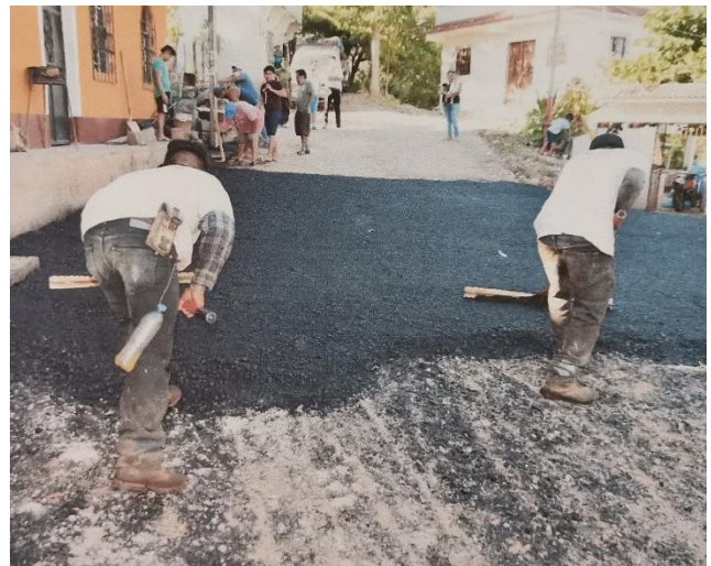
MANTENIMIENTO Y REPARACION DE PAVIMENTO DE CONCRETO ASFALTICO COLONIA HUCHAPI, CHIQUIMULILLA, SANTA ROSA
